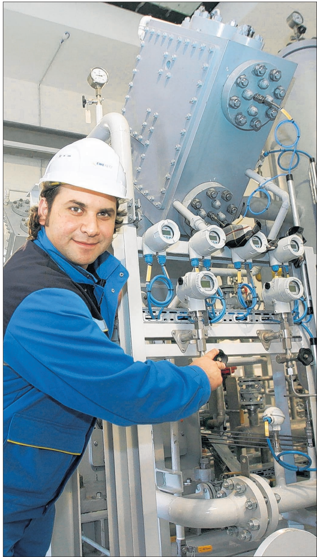
Testphase: Projektleiter Osman Kurt überprüft den Eingangsdruck des Verdichters. Das in der weltgrößten Biogasanlage von Verbio in Schwedt aufbereitete Biogas wird seit gestern probenhalber in das Versorgungsnetz der EWE Netz eingespeist. Foto: MOZ/Karl-Heinz Wendland
